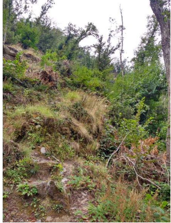
Foto 17 - Miniere di ferro (sentiero esistente completamente danneggiato)
